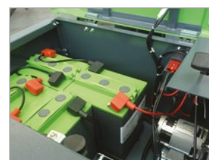
ALOJAMIENTO DE BATERÍAS (1250 E)
