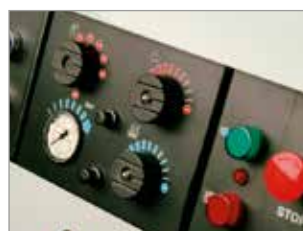
PANEL DE CONTROL CON APAGADO DE EMERGENCIA
