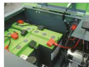
ALOJAMIENTO DE BATERÍAS (1250 E)
