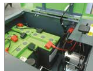
ALOJAMIENTO DE BATERÍAS (1280 E)
