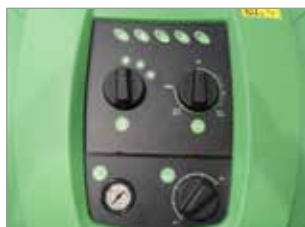
PANEL DE CONTROL CON INDICADORES LUMINOSOS
