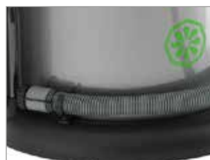
TUBO DI SCARICO
