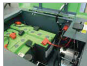
ALOJAMIENTO DE BATERÍAS
